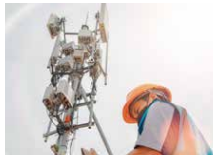
Der 5G-Sendemasten am Zeissberg sollte die Telefon- und Internetqualität vieler Haushalte deutlich verbessern. Darüber hinaus wird die Gemeinde in den betroffenen Regionen aber auch die Glasfaser-Versorgung weiterhin aktiv forcieren.
